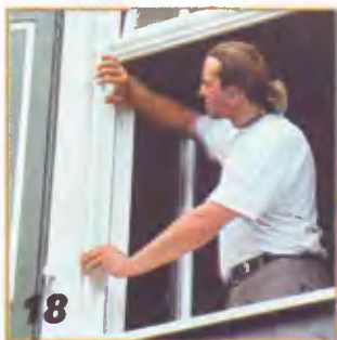
18 На переходе между кладкой и рамой крепят гвоздями изготовленный по месту нащельник.
