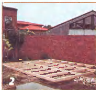
Брусья обвязки, продольные и поперечные балки платформы соединяют с помощью мощных металлических уголков и оцинкованных шурупов.
